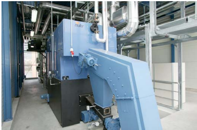
La caldaia a legna di 650 kW, cuore dell'impianto.
