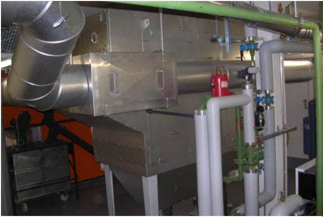
Il filtro elettrostatico per l'abbattimento delle polveri.
