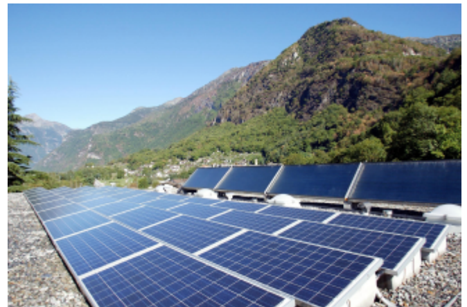
I moduli fotovoltaici (elettricità), davanti ai collettori termici (acqua calda).
