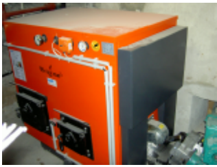
La caldaia a legna automatica.
