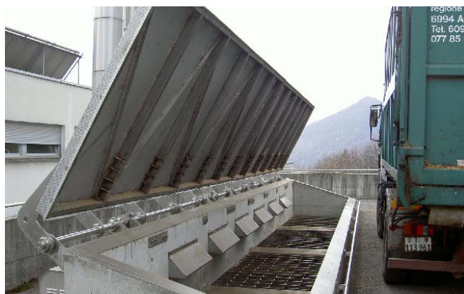
La botola del silo del cippato.
