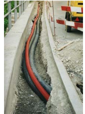
Le condotte della rete di teleriscaldamento.
