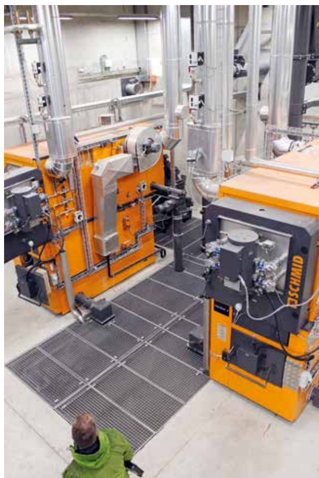
Il cuore della centrale termica a cippato della Base Aerea di Locarno Fonte: AELSI
