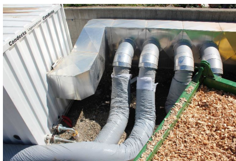
Collettore aria calda
