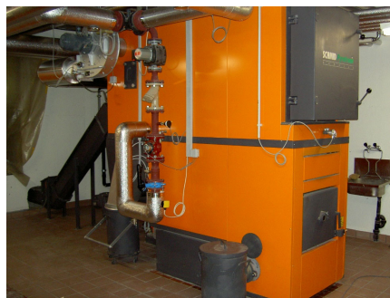
Caldaia a cippato
