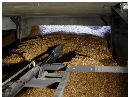
Interno silo cippato
